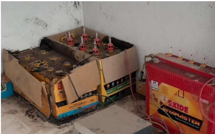
a) Electrical Invertor: 0.5 KW (1 Nos.)
